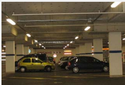
Tiefgarage in Prenzlauer Berg: 40 Prozent weniger Stromverbrauch dank moderner Technik
