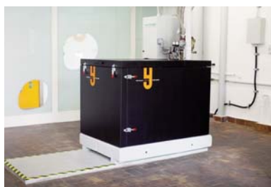
Blockheizkraftwerk im Lindenhof
