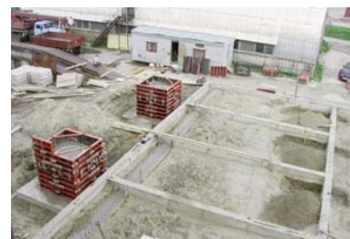
In der viertgrößten Stadt Lettlands, Jelgava, hat die Berliner Energieagentur geholfen, ein modernes Heizkesselhaus zu bauen.
