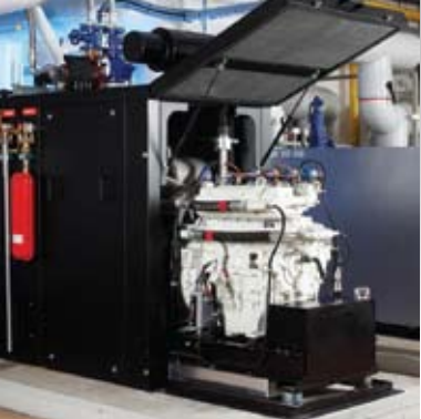
Dezentrale Energieversorgung mit effizienter KWK-Technik.
