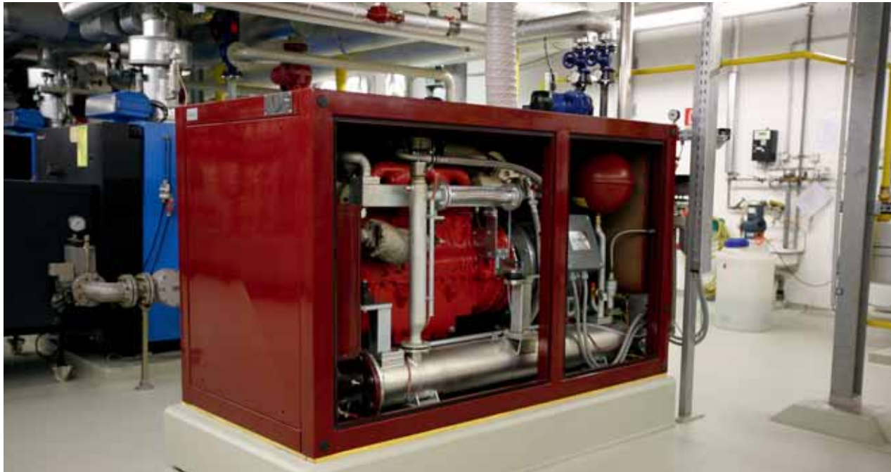
Blockheizkraftwerk in einer modernen Heizzentrale
