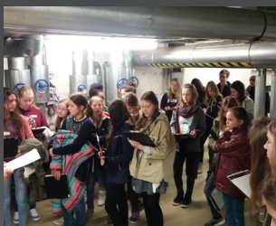
Mädchen schnupern Praxisluft als Energieberaterinnen und erkunden am Girls'Day die Heizzentrale eines Bürogebäudes. Copyright: Berliner Energieagentur
